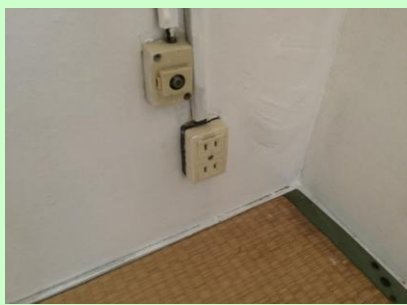
コンセントあり
