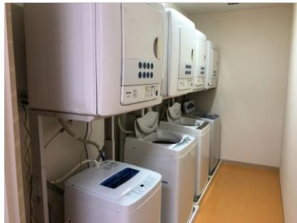
洗濯機・乾燥機
