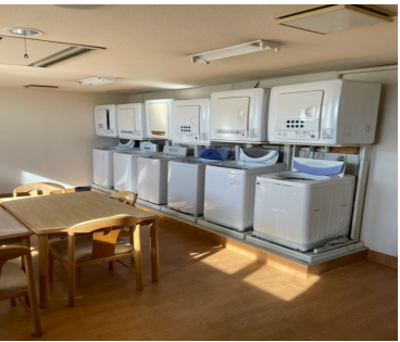
洗濯機（共用部）
