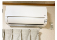
エアコン(個室)
